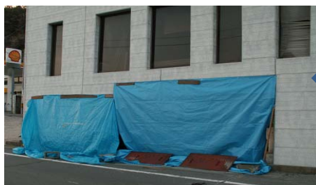
【津波被害により倒壊した中之作支店】
